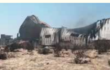
破壊されつくした医薬品倉庫
